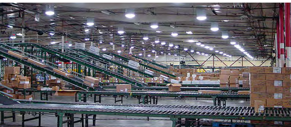
Einsatz von Solatube in einer Logistikhalle
